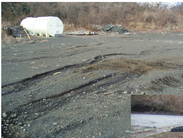
・施工箇所近くの浸食状況
